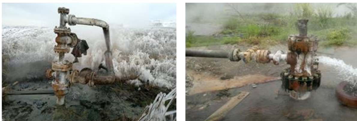
Рис. 1. Состояние геотермальных скважин
